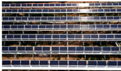
南宁镜阵光伏商业电站一角
