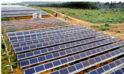
镜阵光伏发电单元阵列
